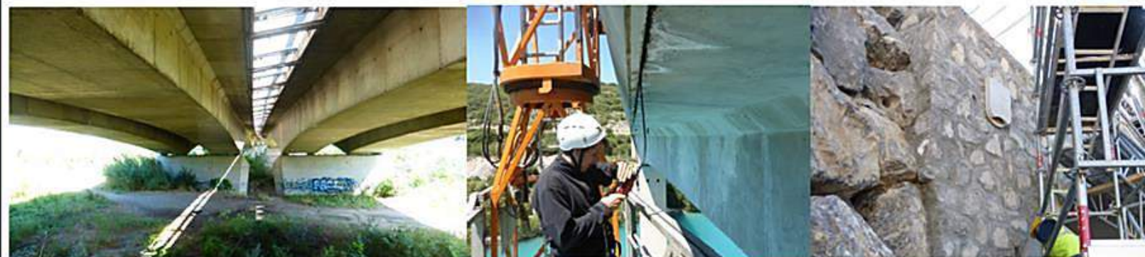
Figure 47 : Mise en place de gîtes pour chiroptères sur un ouvrage d'art (photos Naturalia)
